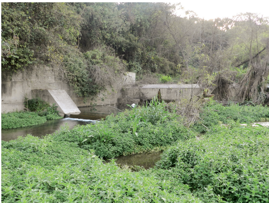
Figura 5. Obras de encauzamiento del Río Muerto, Yerba Buena, Departamento Yerba Buena, Tucumán. Hábitat de Erythrolamprus ceii en un ambiente semi antrópico, con restos de vegetación natural.
